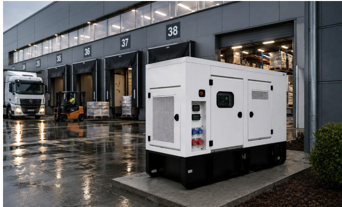
Dieselgestützte Notstromversorgung für Logistikzentren
