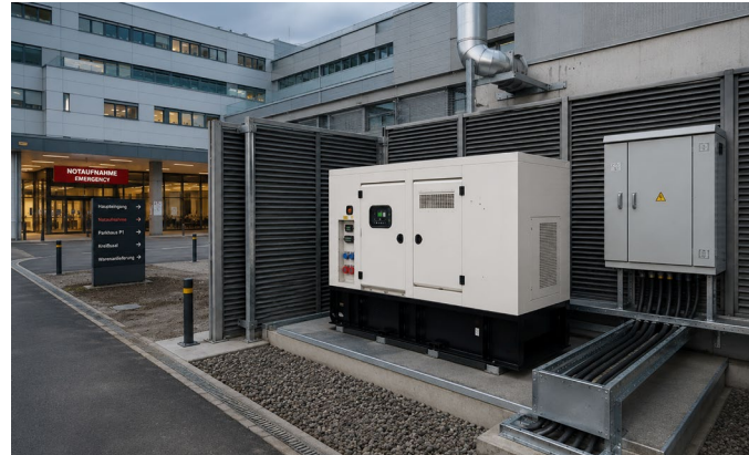
Dieselgestützte Ersatzstromversorgung für KRITIS
