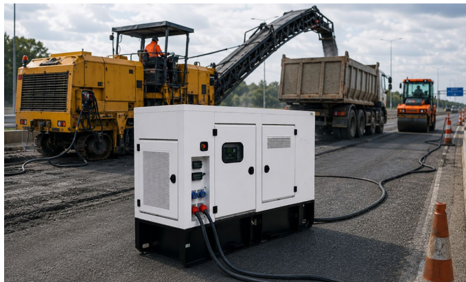
Dieselgestützte Primärstromversorgung für Baustellen
