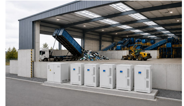
Prozessoptimierung mit PV und BESS
