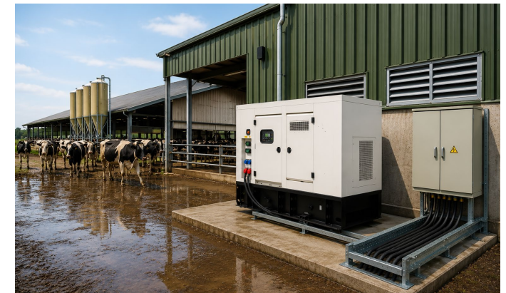
Notstromversorgung für Tierhaltung und Landwirtschaft
